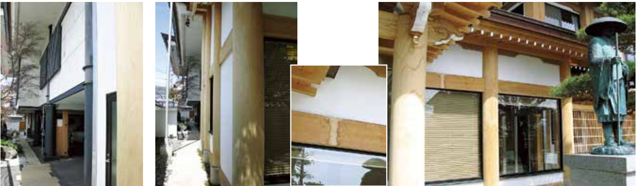
▲塗装が劣化している本堂鉄柱と窓格子
